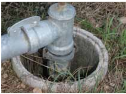
>> 2 hérissons sont morts dans ce système d'irrigation.
