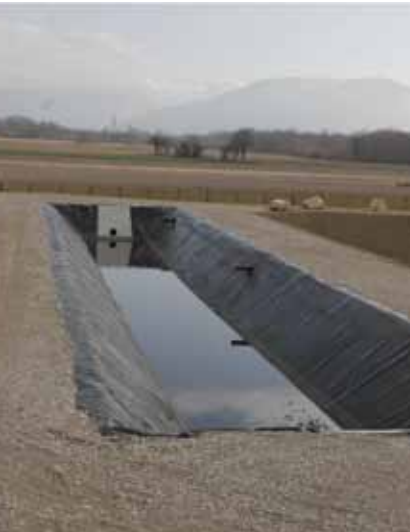
>> Bassin de décantation avec géo membrane.
